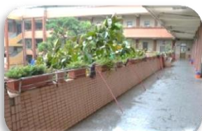
圍牆過低-易發生墜落危險
